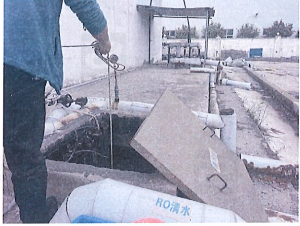
渗滤液处理站出口
